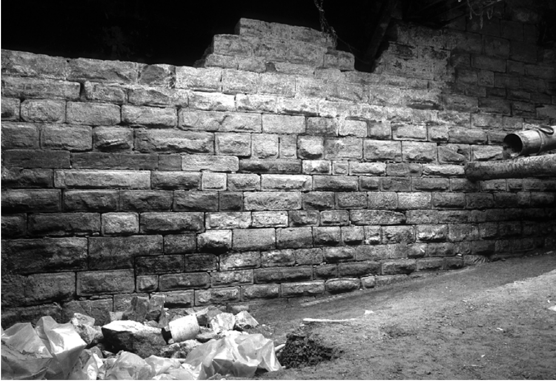
110 Fundament der Inneren Stadtmauer unterhalb der Fassade des Casinos, Steinenberg 10, Aufnahme von 1991. — Der Bereich um den Birsgeinfluss wurde mit Sandsteinquadern verstärkt, um die Bewohnerinnen und Bewohner vor Hochwasser zu schützen.
